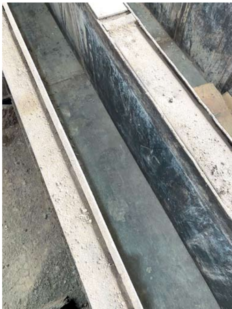
Рис. 1. Образование цементного молочка на стенках опалубки
