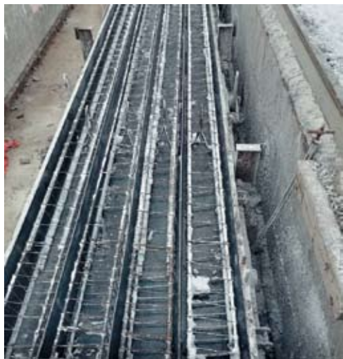
Рис. 2. Пример наличия снега и наледи в опалубке свай
