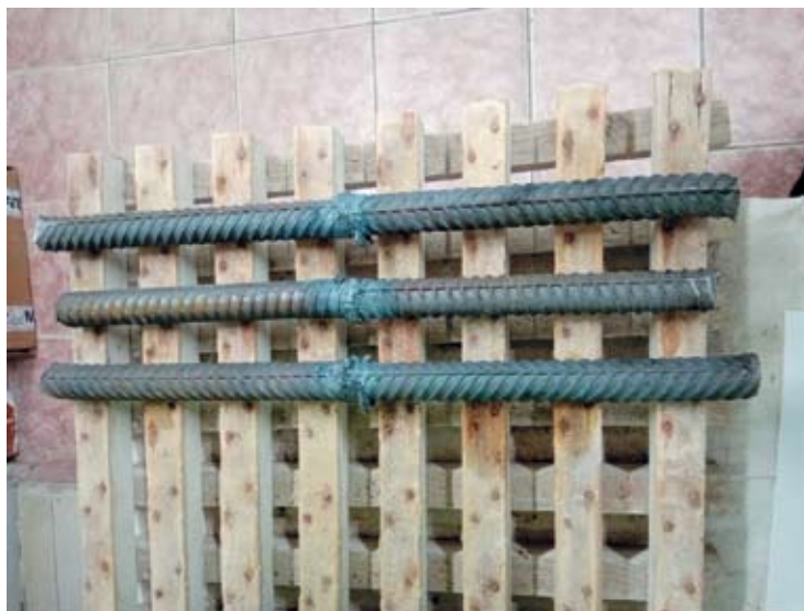
Рис. 3. Пример неправильного стыкования рабочих стержней арматуры
