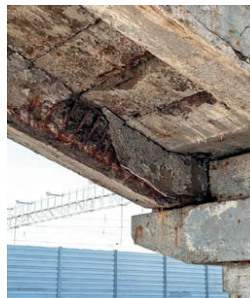
Рис. 2. Щелочная коррозия бетона пешеходного перехода
